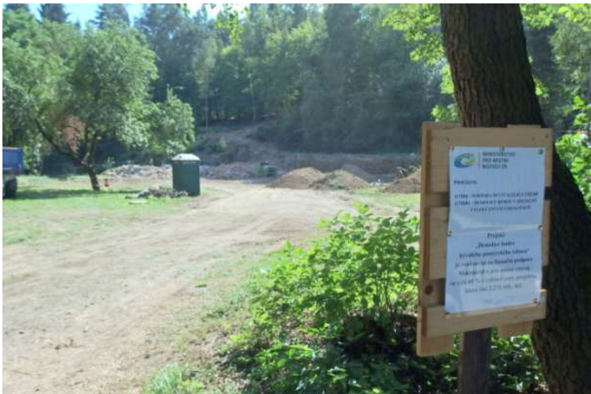
Zbývající demoliční odpad připravený k odvezení a hlína přivezená k použití na terénní úpravu po demolici.
