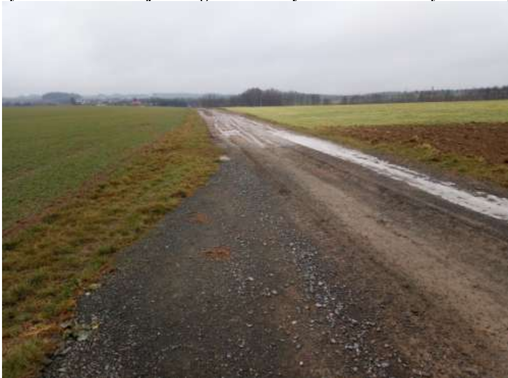
↑ Pohled od Ochoze z části komunikace (výhybny) realizované jako 2. etapa výstavby v roce 2017.
