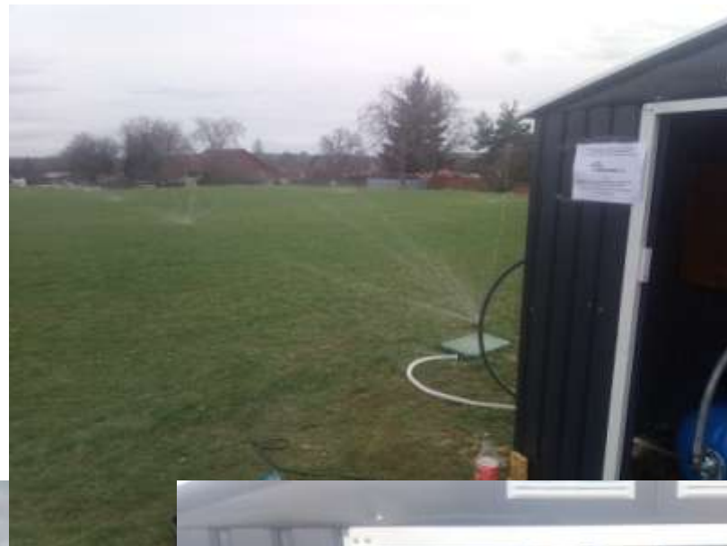
Listopad 2021 – zkouška funkce zavlažovacího systému
